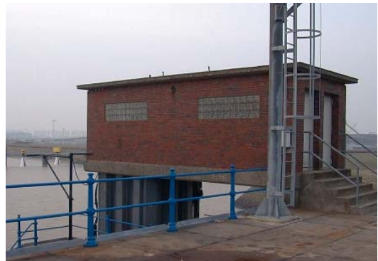
Bild 1: Pegelstation mit Pegelhaus und Schwimmerschacht, links im Bild die Radarsensorik im Größenvergleich.
